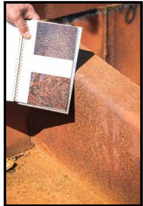
KONTROLL AV ROSTGRAD
